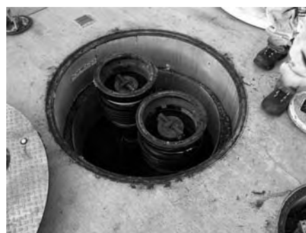
注油口とベーパー回収口が並んで設置されている
