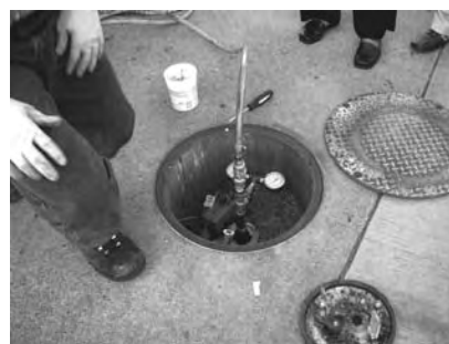
二重殻タンクの減圧検査
