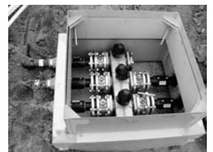
配管マニホールド。
