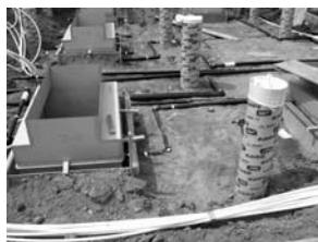
縦横に走る配管。手前の白っぽい管は、泡消火設備の配管。
