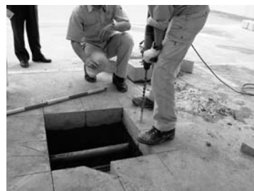
ハンマードリルによる埋設配管の損傷実験
